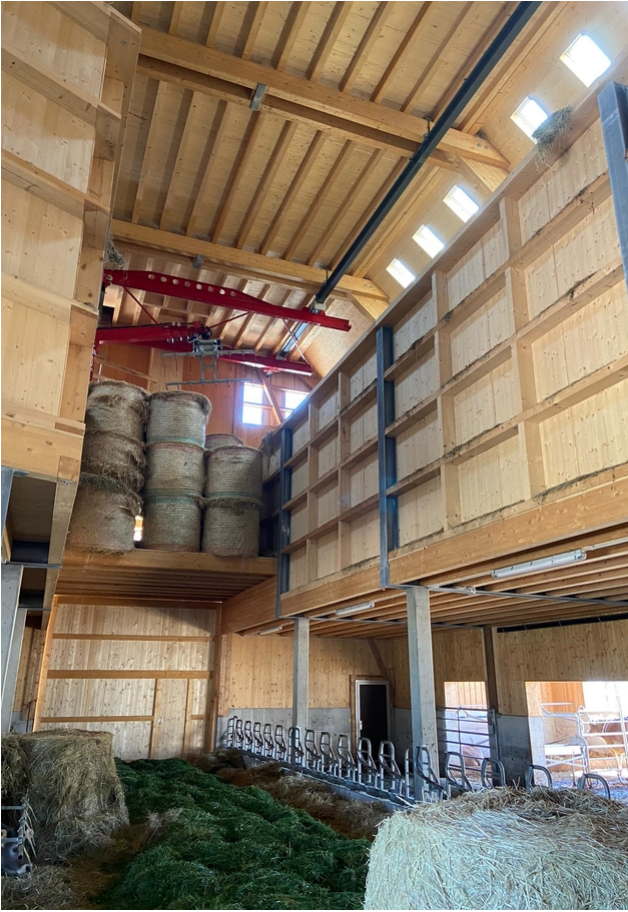
Aufhängung Heukran in der Scheune
