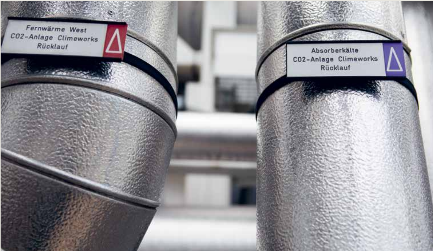
À Hinwil, la chaleur utilisée pour chauffer les filtres à CO 2 provient de l'incinération des ordures ménagères.
